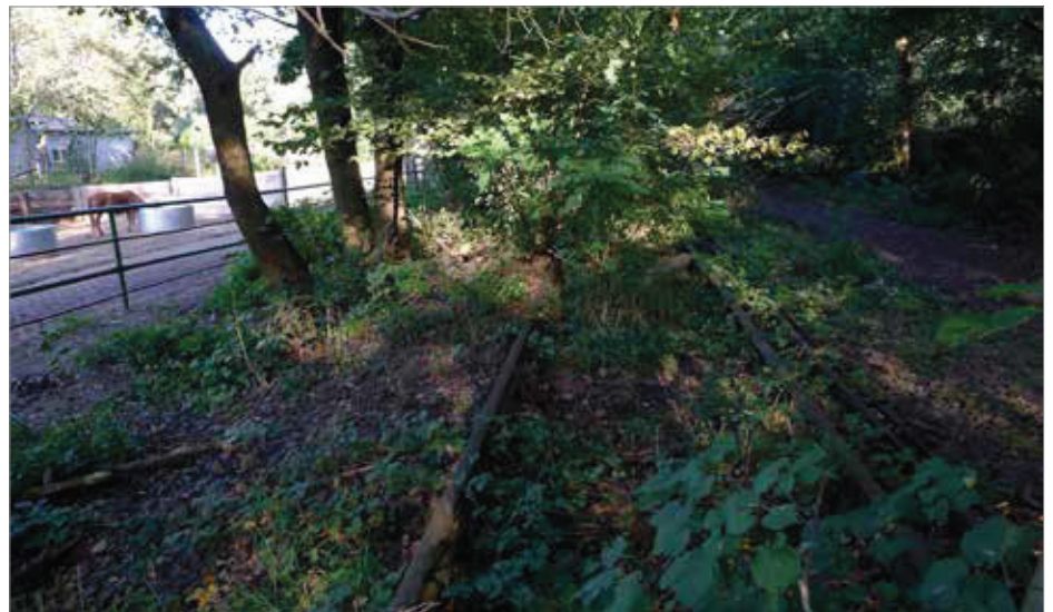
Stammbahn Gleis außer Betrieb nahe Clauerstraße. Auf dem ehemaligen zweiten Streckengleis befindet sich zurzeit ein Fußweg. Foto (Okt. 2021): BSBB
